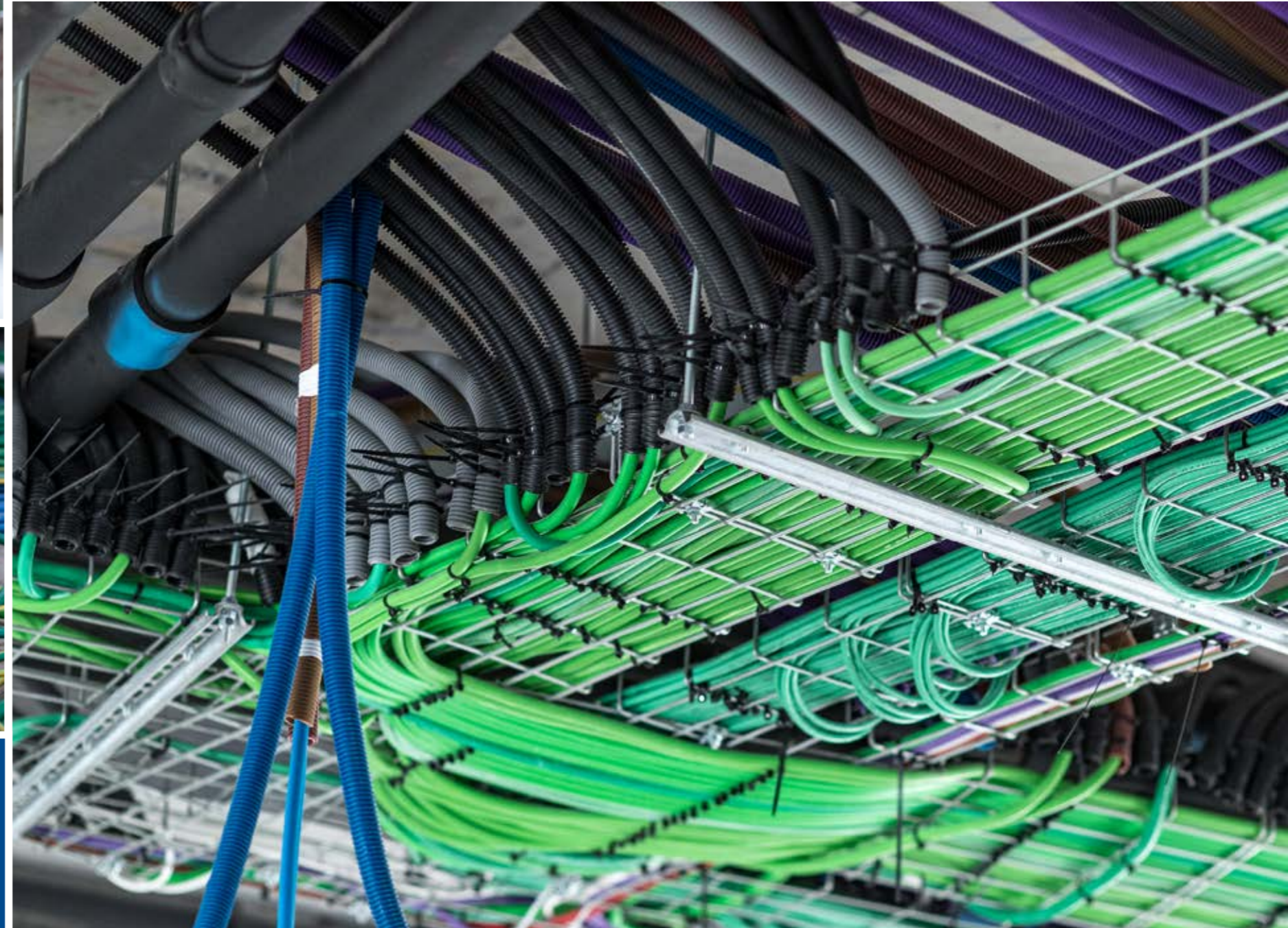
POSA DELL'IMPIANTO ELETTRICO E DI TRASMISSIONE DATI VERLEGUNG DES ELEKTRO- UND DATENÜBERTRAGUNGSSYSTEMS
